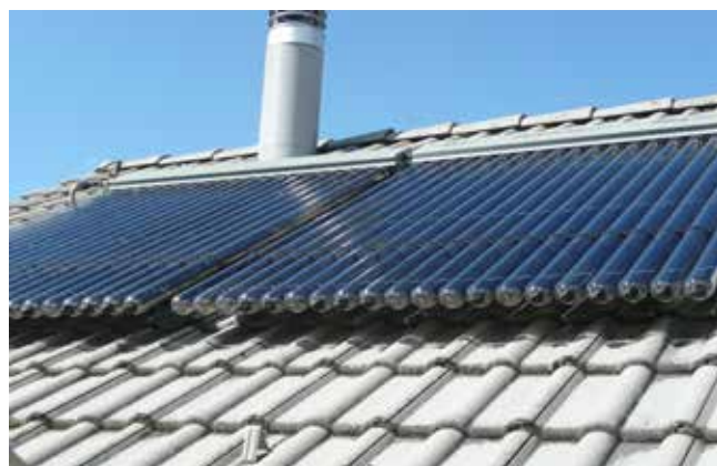
Collettori solari, ad esempio sul tetto, per ottenere l'acqua calda per uso domestico.
