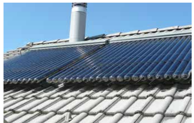
Sonnenkollektoren, zum Beispiel auf dem Dach, zur Erzeugung von Warmwasser.
